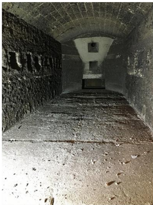
Ovn 2 før test del 1
